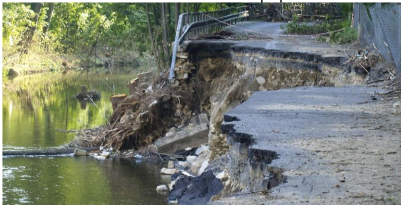
Obr. 4 Komunikace se ztrátou funkčnosti po poškození mimořádnou událostí
